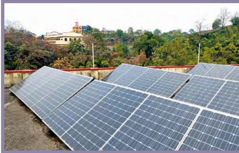
Solarzellen auf dem Dach des St. Francis Eco-Spirituality Centre im indischen in Orlong Hada, eines der Nachhaltigkeitsprojekte von missio.
